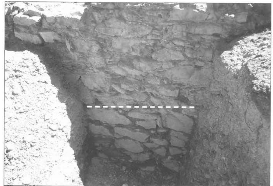
Abbildung 5: Freigelegtes Turmfundament mit eingestrichelter ursprünglicher Bodenhöhe
