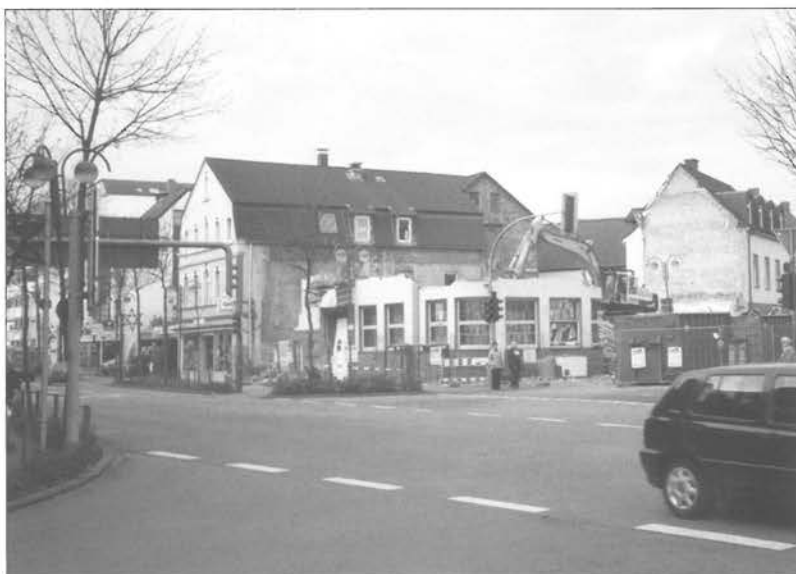
Die letzten Mauerreste des Westfalenhofes. Aufnahme am 18.11.2002 (Foto: Walter Göbel)
