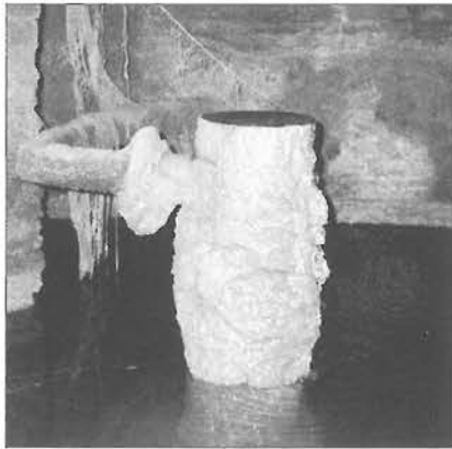
Abb. 6: Kopf des Brunnenrohres der alten Fassung mit dicker Eisenoxid-Umkrustung (Foto: Perbix)
