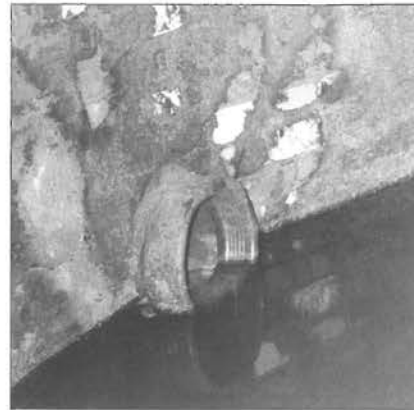
Abb. 7: Überlauf der Brunnenkammer der alten Fassung in die Kanalisation (Foto: Perbix)
